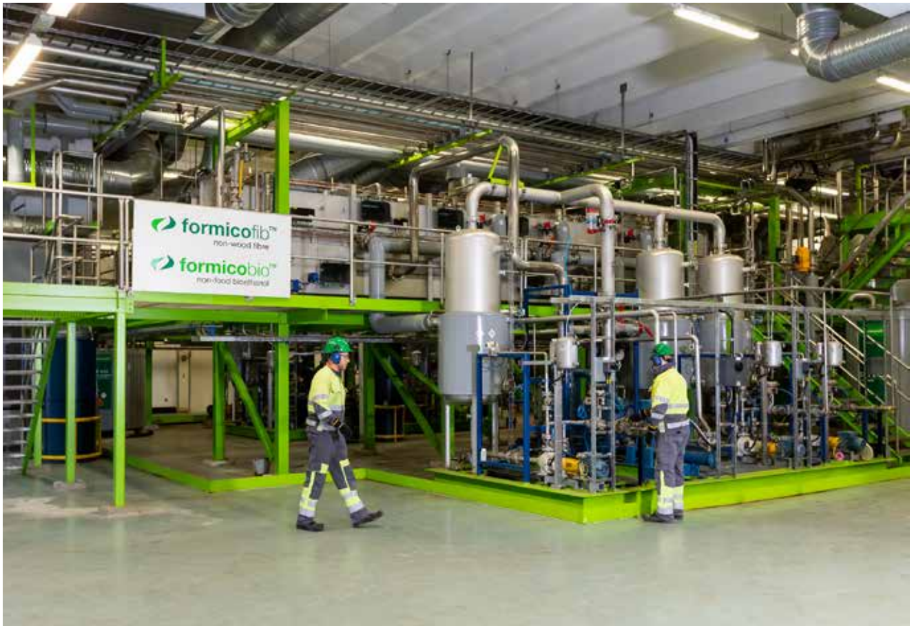
PCS-Engineering on toimittanut Chempoliksen biojalostamolle muun muassa Siemensin Simatic PCS 7 -automaatiojärjestelmän.
