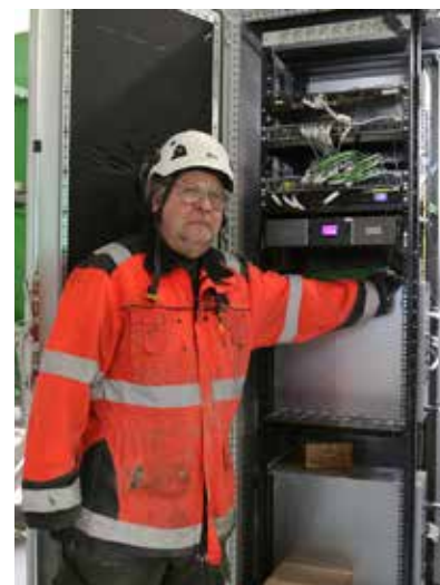
ZenRoboticsin vanhempi huoltoteknikko Matti Raivonen sovittaa robottijärjestelmää toimimaan optimaalisesti syötteenä tulevalle materiaalille.
