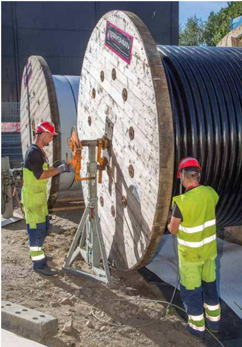
Helen Sähköverkko Oy:n 110 kV kaksoiskaapeliyhteyteen asennettiin osittaispurkausmittausjärjestelmän ja jatkuva-aikaisen lämpötilavalvonnan yhteen integroiva ratkaisu.
