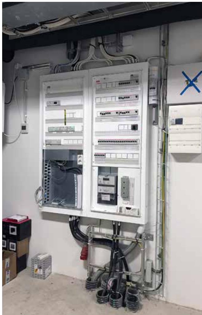
Normaalin kodin hermokeskus, jossa mittauskeskus, automaatiolaitteet, tele- ja dataosa sekä murtovalvontakeskus siististi asennettuna.
