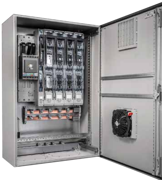
Turvallinen, hyvin suunniteltu ja testattu sähkökeskus palvelee pitkään turvaten kiinteistön sähköjakelua
