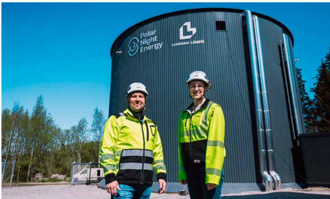
Loviisan Lämpö käynnisti maailman suurimman hiekka-akun. Polar Night Energyn kehittämä teollisen mittakaavan hiekka-akku toimii Pornaisten kaukolämpöverkon päätuotantolaitoksena. Kuvassa Loviisan Lämmön toimitusjohtaja Mikko Paaanen ja Polar Night Energyn operatiivinen johtaja Liisa Naskali.
