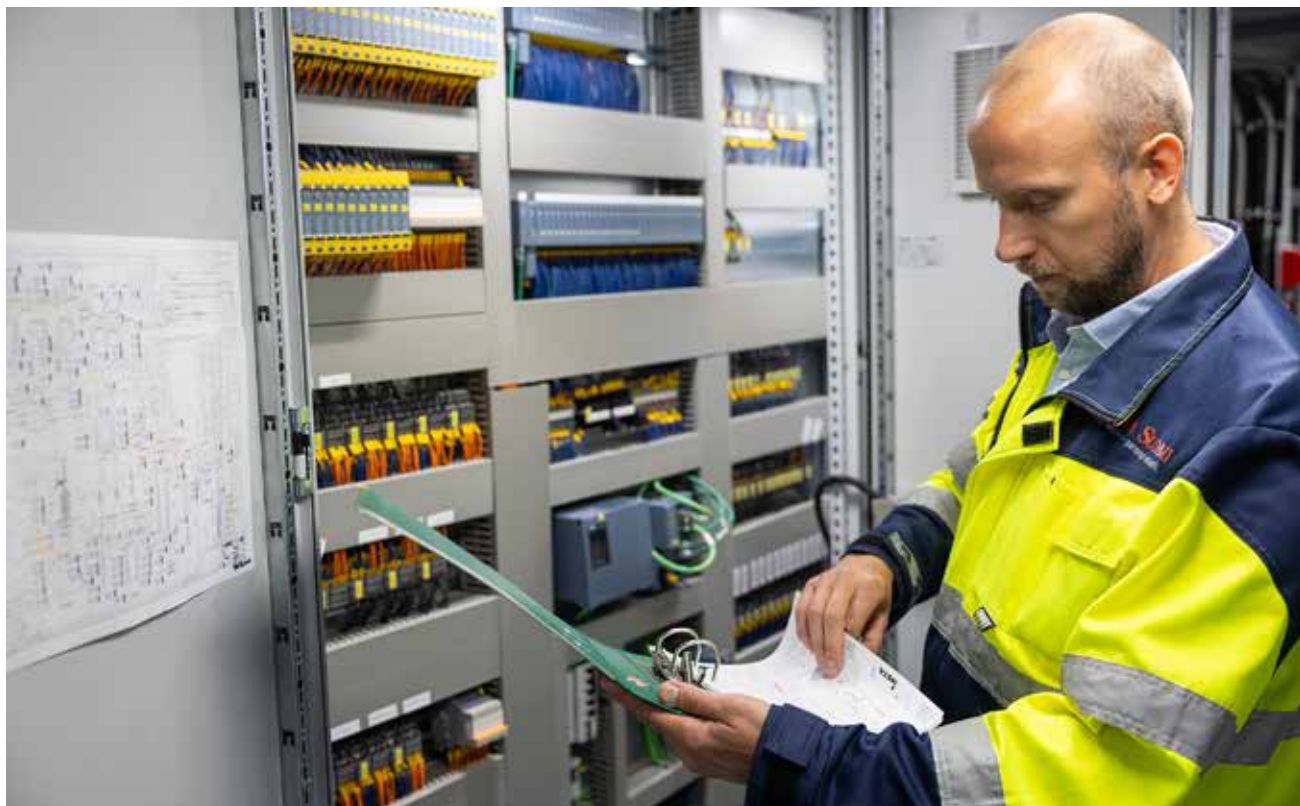
Automaatiokaapit sijaitsevat omassa teknisessä kerroksessaan turvassa pesuedeltä. Pasi Marttila tutkii sähkökuvia.
