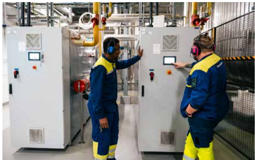
Sinebrychoffin panimoprosessin lämpö on otettu talteen jo vuodesta 2016. Kuvassa Zakaria Kibona ja Joonas Makkonen lämmön talteenottoon liittyvien lämpöpumppujen äärellä.
